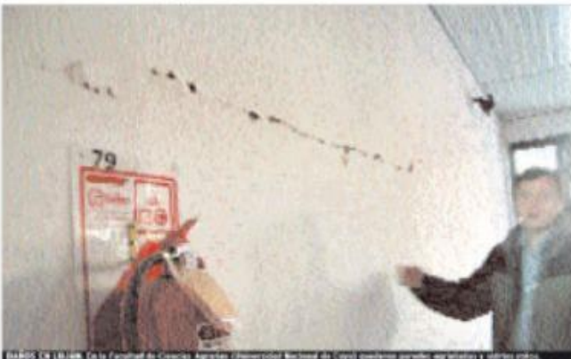
SIEMPRE EN LA LINEA: En la Facultad de Ciencias Agrarias (Universidad Nacional de Cuyo) quedamos paredes, agrietadas y cubiertas rotas.
