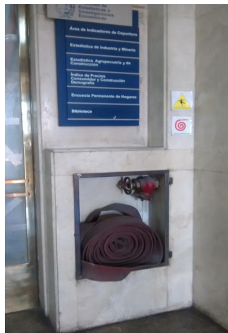
Manguera en desuso
